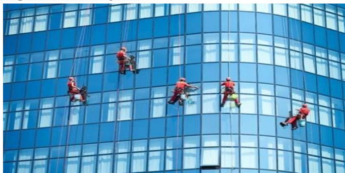
Rasm 1. Balandlikda bajariladigan ishlarda xavfli holatlar
